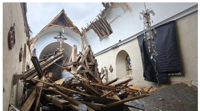
Effondrement du clocher de l’église de Valaille © Nicolas Wasylszyn, UDAP 27
